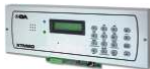
XTM20 (in prossimità della centrale)
